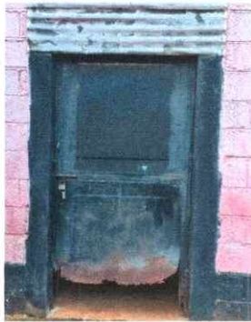
Foto 3: Se observa una de las puertas que necesita sustitución
